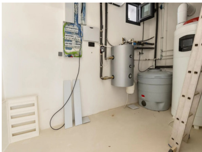
Cuarto técnico de la villa energéticamente eficiente
